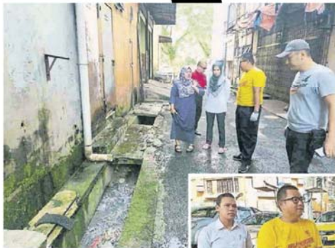
■商业中心后巷沟渠卫生情况令人摇头。
